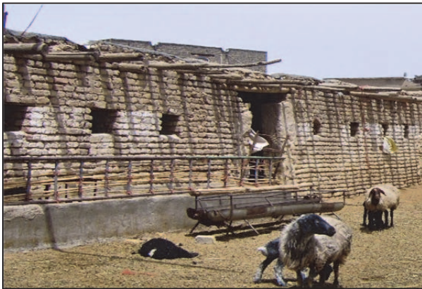
شکل ۱۸- استفاده از سقف تیر چوبی و کاهگلی با کیفیت نامناسب
